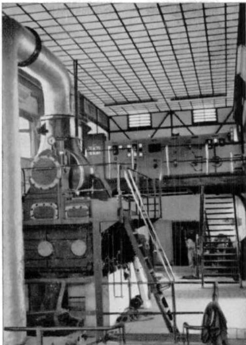
FIG. 4. — Centrale de Kiabukwa, vue vers le tableau de commande.
