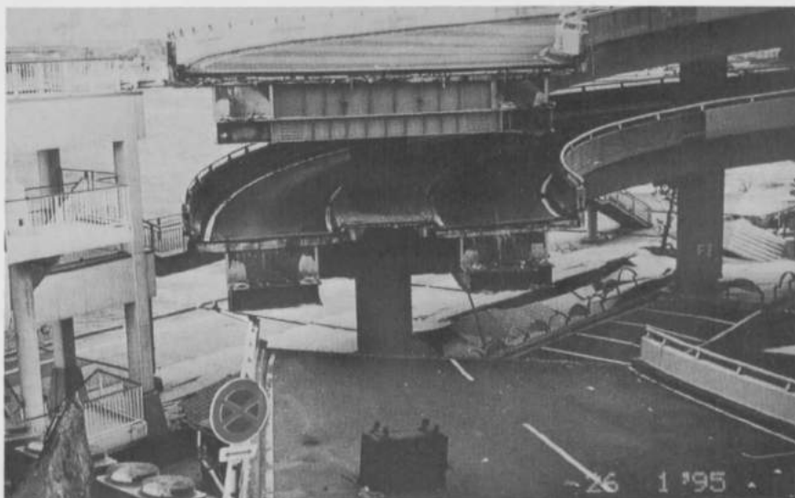
Fig. 24. — Bezwijken van het brugdek van de Wangan snelweg tijdens de aardbeving te Kobe (1995).
