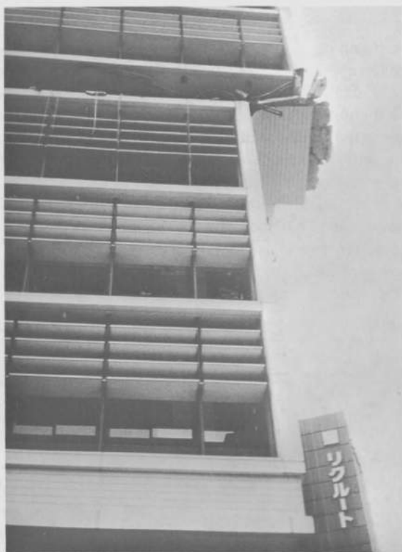
Fig. 23. — „Soft storey failure” (Kobe, 1995).
