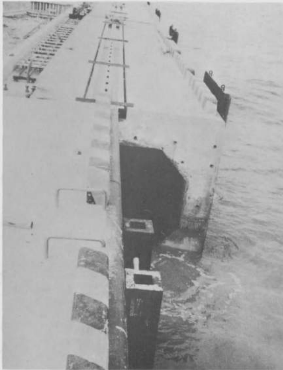
Fig. 26. — Kaaimuurschade in de haven van Kobe (1995).
