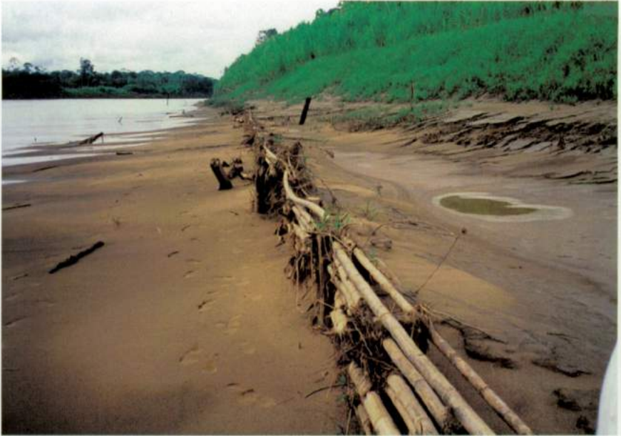
Fig. 6. — Détail de l'épi-guide «B1» après une crue en 1995.
