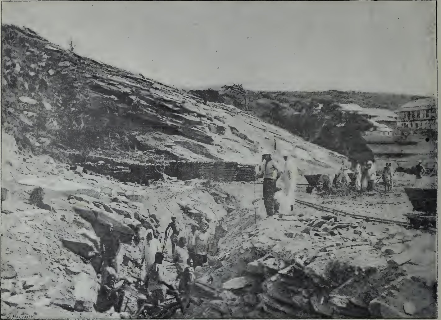
Matadi. — Les travaux d'aménagement de la gare. (D'après une photographie de M. De Meuse.)
