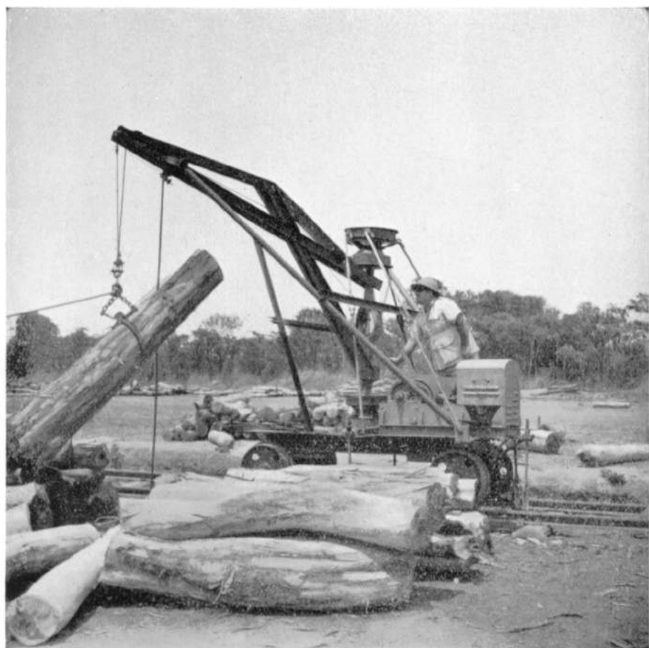
FIG. 8. — Grue de fortune utilisée pour les essais de mécanisation du chargement sur wagon.
