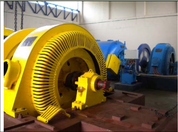
Une turbine flambant neuve de la centrale EDC située à Tshikapa et construite en PPP avec le gouvernement congolais.
