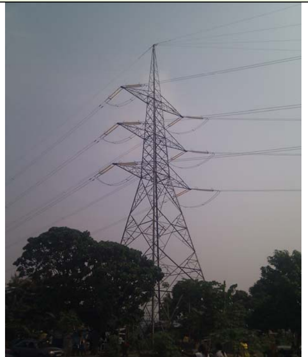
Pylône électrique aux abords de Kinshasa
