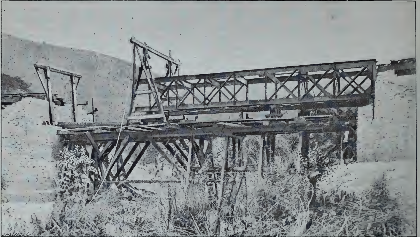
Construction du pont de Pondene, kilomètre 17.5. (D'après une photographie de M. l'ingénieur Limmelyn.)
