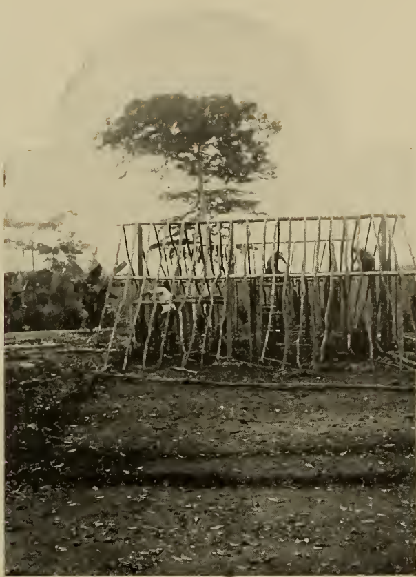
PREMIÈRE PHASE DE LA CONSTRUCTION D'UNE HABITATION (Voir le texte pour l'explication de cette gravure et des cinq photographies suivantes)
